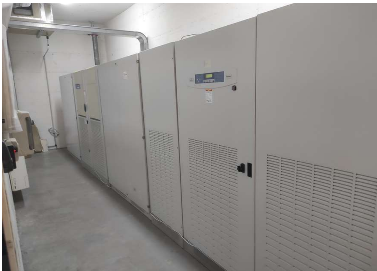
Figura 1: I due UPS e i relativi armadi batterie
