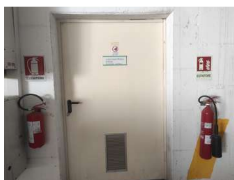
Figura 2: Porta di accesso sala UPS
