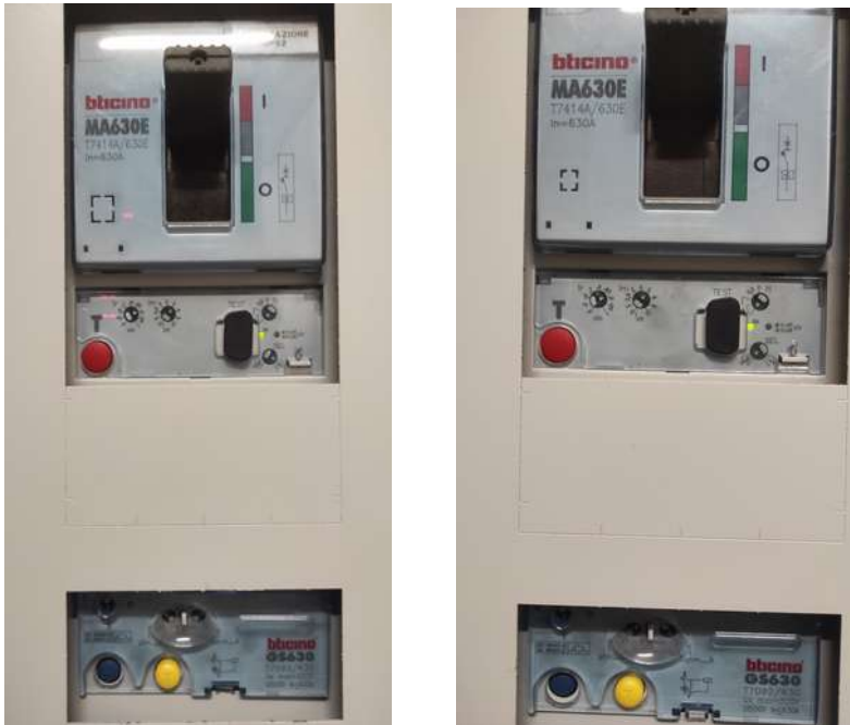
Figure 4 – Interruttori magnetotermici e differenziali a protezione degli UPS
