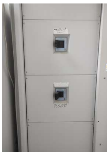
Figura 3: Armadio laterale interruttori a valle degli UPS
