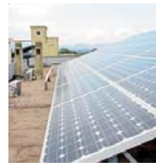
Un impianto fotovoltaico
